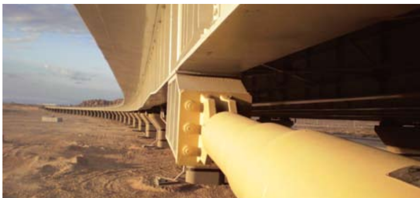
Рис. 2. Система сейсмобезопасности на путепроводе в Туркменистане
